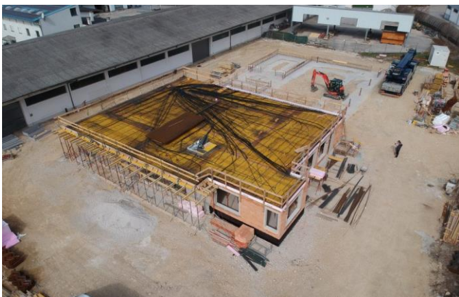
Ein Schnappschuss von der Drohne bevor die nächsten Betonierarbeiten weitergehen. Die Maurer und Elektriker haben ganze Arbeit geleistet und die Erdgeschossdecke vorbereitet.
