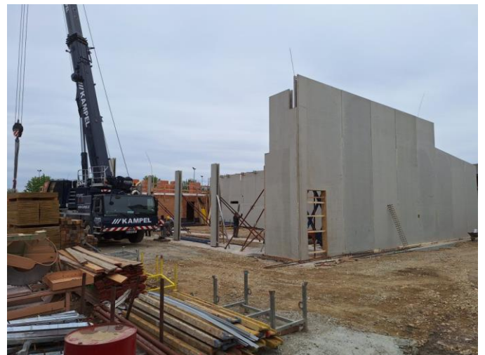
Gleich nach Ostern wird mit dem Aufbau der Fahrzeughalle gestartet. Und das geht sehr flott...
