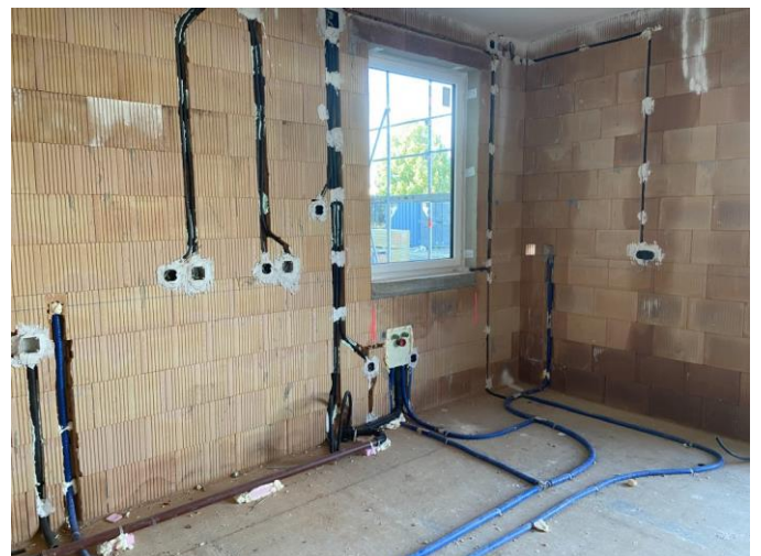
Die Stemmarbeiten laufen auf Hochtouren. Sowohl der Elektriker wie auch der Installateur haben alle Hände voll zu tun und sie machen beide einen großartigen Job.
